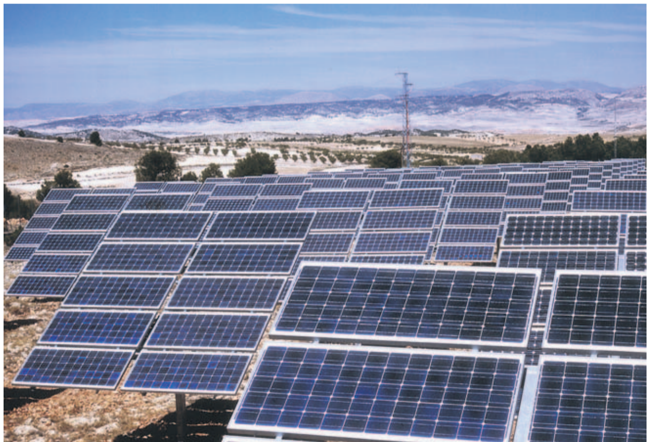
Planta fotovoltaica de Endesa.
