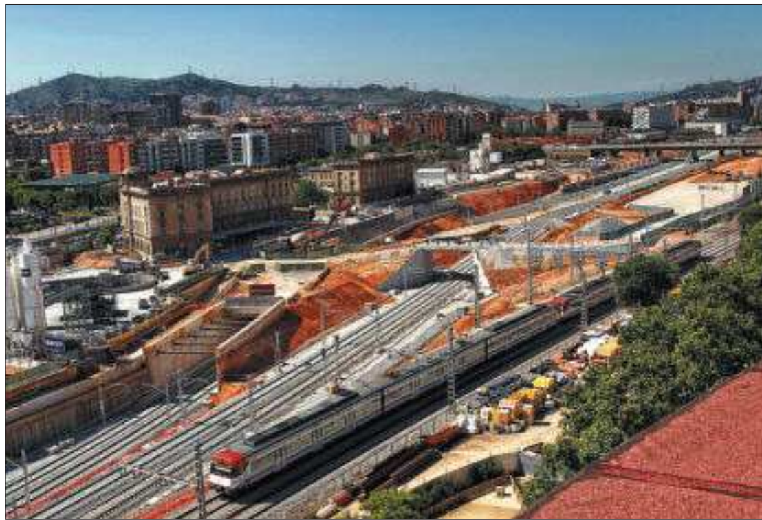
Los trabajos de construcción de la estación intermodal de la Sagrera, ayer / MARCEL·LÍ SÀENZ
